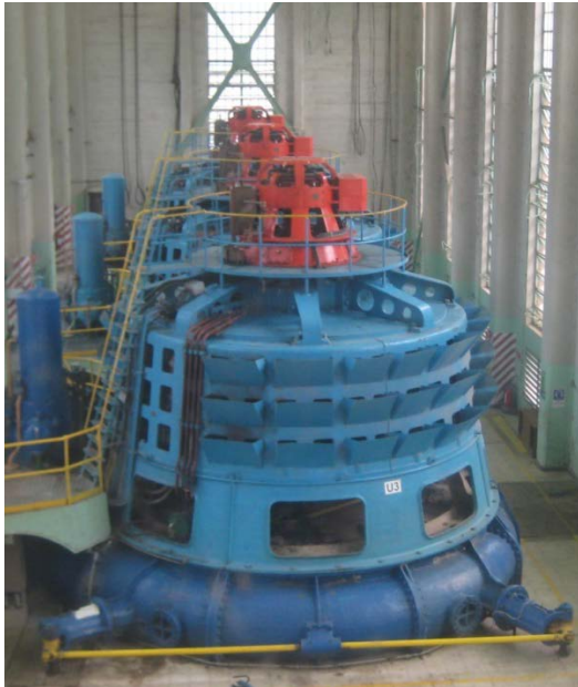
Central Hidroeléctrica Alfalfal
